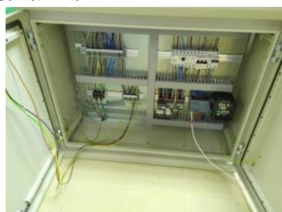
ภาพที่ 7.1-75 ชุดควบคุมด้วย PLC
