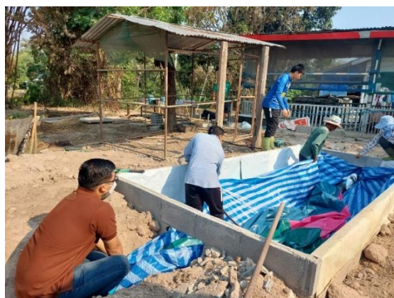
ภาพกิจกรรมที่ 8.2 การวางถุงลมพลาสติก
