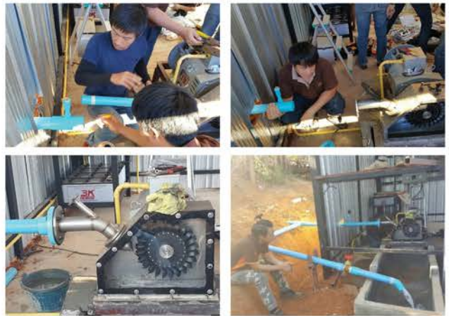
รูปที่ 6 การติดตั้งเครื่องกำเนิดไฟฟ้าพลังน้ำ
