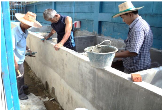
รูปที่ 12 การสร้างระบบบำบัดน้ำเสียแบบบึงประดิษฐ์ของโรงเรียนบางแค (เนื่องสังวาลย์อนุสรณ์)
