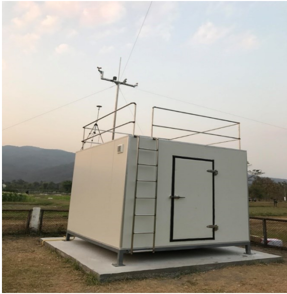
(ก) โครงสร้างสถานีพร้อมระบบปรับอากาศ
