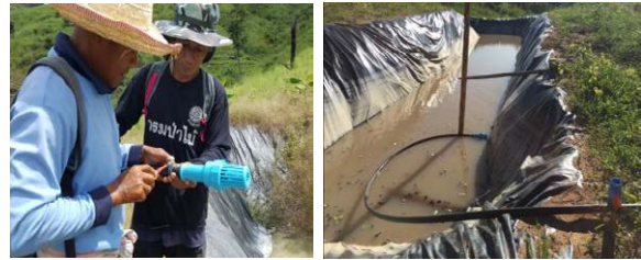
ภาพที่ 7 การติดตั้งระบบกาลักน้ำ
