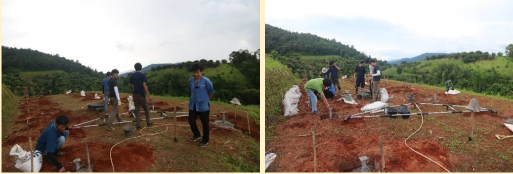
การเตรียมฐานก่อนการขึ้นโครงและติดตั้งโรงเรือนน็อคดาวน
