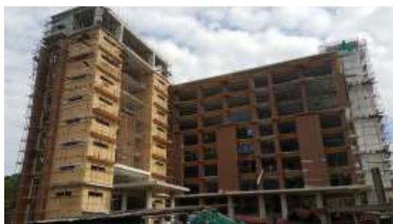
อาคารเรียนรวมและปฏิบัติการพร้อมครุภัณฑ์ และอาคารประกอบ จ.เชียงราย
